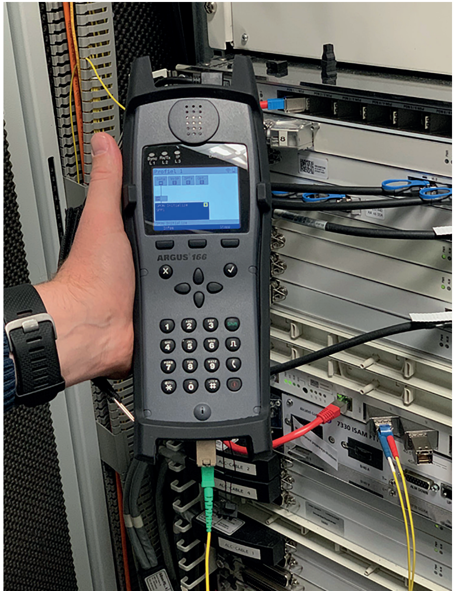
Bild 3: Nachrüstlösungen für xDSL-Bestandsgeräte von Intec erlauben gleichzeitig eine kalibrierte Dämpfungsmessung, das Auslesen der PON-ID und Performance-Messungen von Down- und Upload, wie hier am Argus xDSL-Tester (Fotos: Intec)
